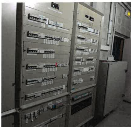
Disjoncteur principal (sous-sol)
